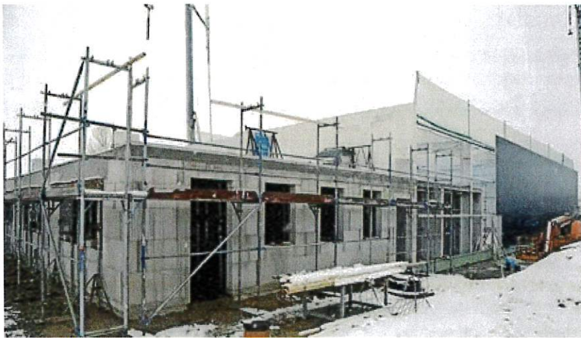
An der Straße der Deutschen Einheit Geithain errichtet die Ausbau Geithain GmbH ihren neuen Firmensitz. © Quelle: Jens Paul Taubert
